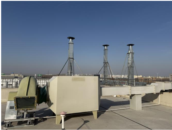
应急废气治理设施
