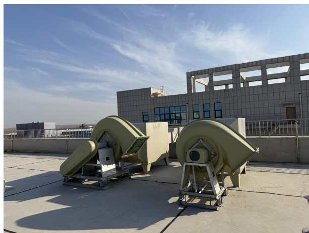
废气治理措施
