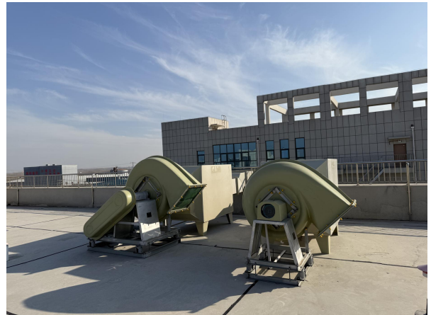
应急废气治理设施
