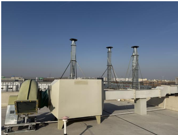
废气治理设施
