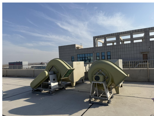
废气治理措施
