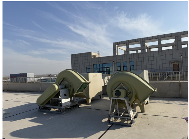
废气治理设施
