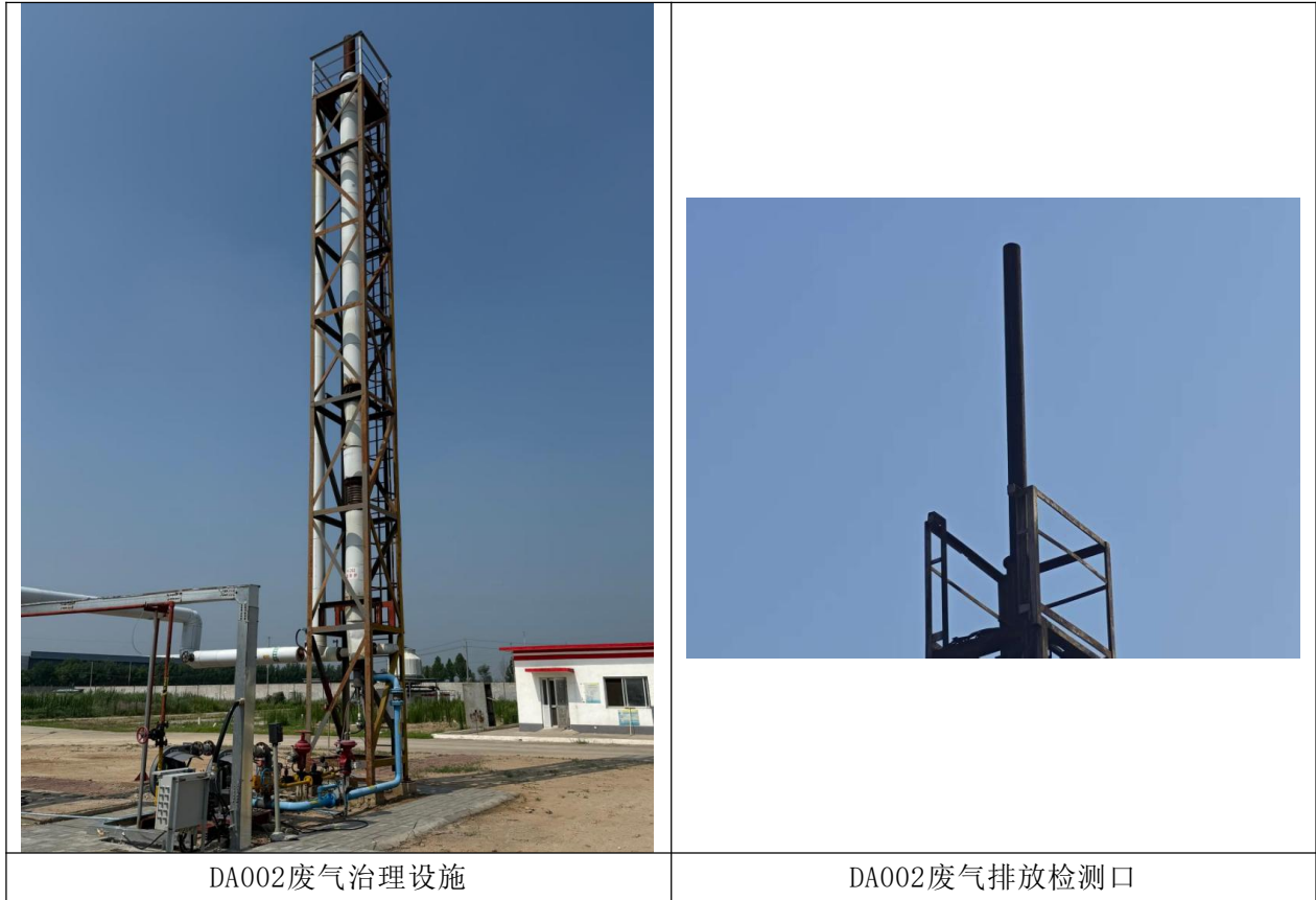
图3.1-3 废气治理设施及监测平台排放口
