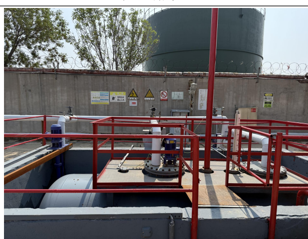
污水收集转输储罐 ↑
